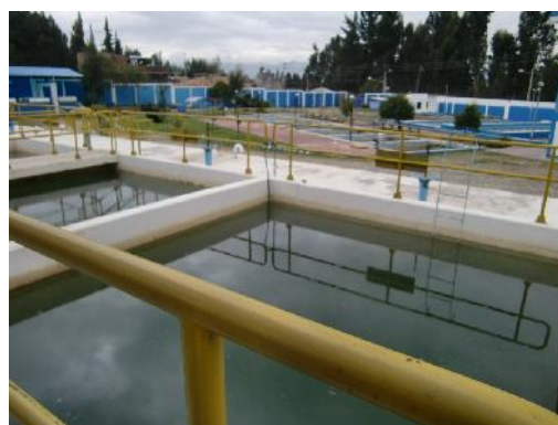
Planta de tratamiento SEDAM Huancayo
